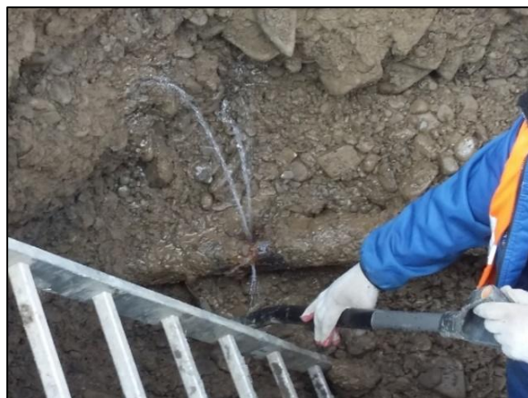
Rysunek 7. Złamanie wodociągu żeliwnego o średnicy 100 mm.
