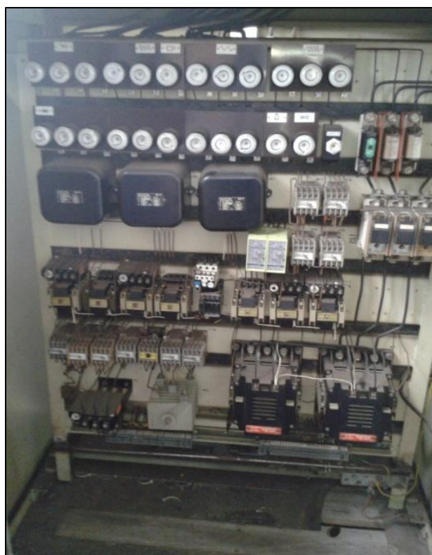
Rysunek 2. Przykładowa szafa sterownicza, zbudowana w oparciu o układy stycznikowo-przełącznikowe. Źródło: www.bipal.pl (dostęp: 12.04.2017).
